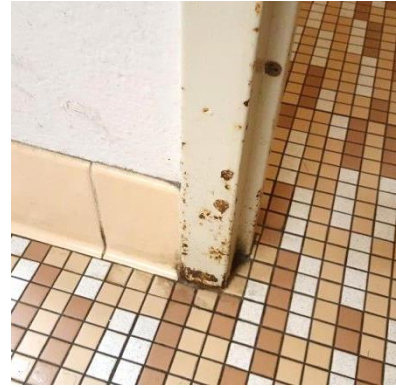
Rusted Door Frame
