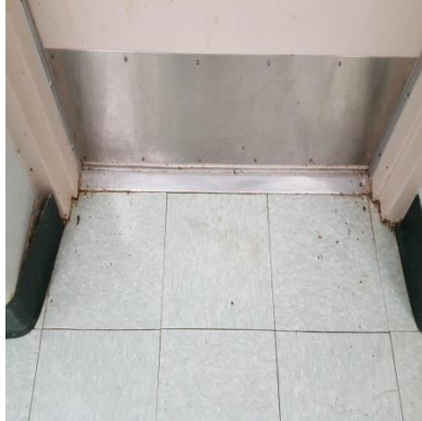
Rusted Metal Door/Frame
