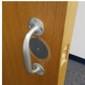
Replaced Door Knob
