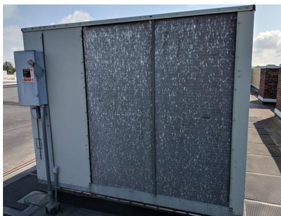
Cooling fins on RTAC 1
